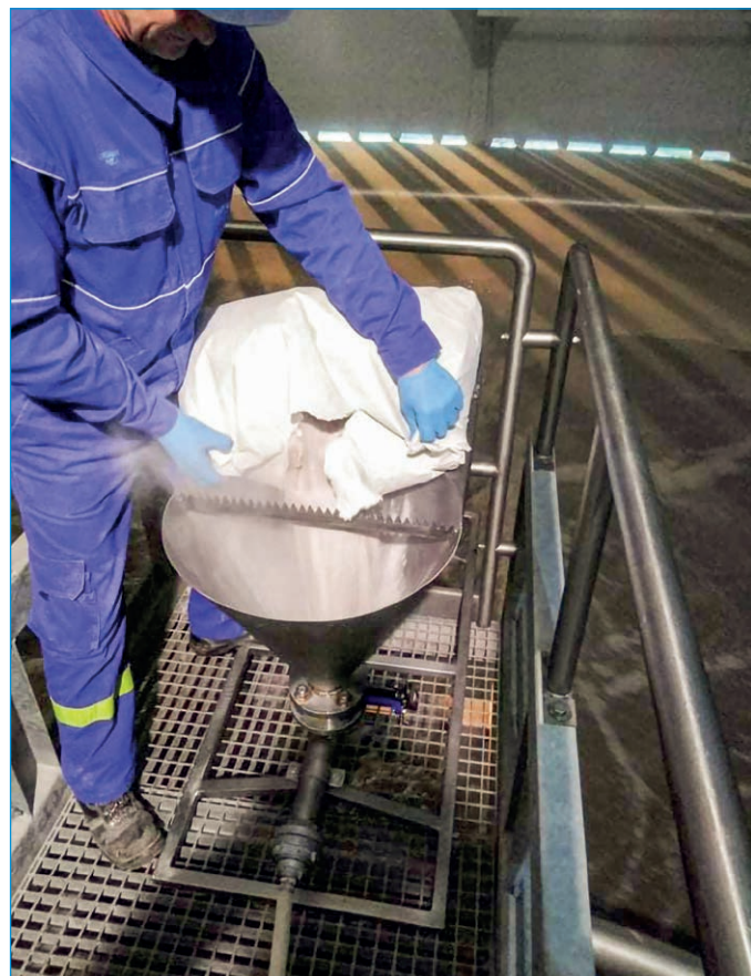
Rys. 2 | Dozowanie BX10 na oczyszczalni w Józefowie
