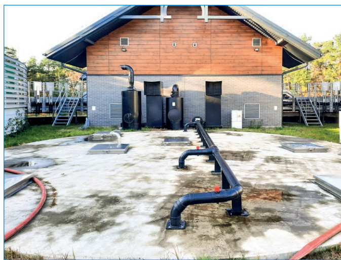
Rys. 5 | Zbiornik KSTO wraz ze zbiornikiem na osad zagęszczony
